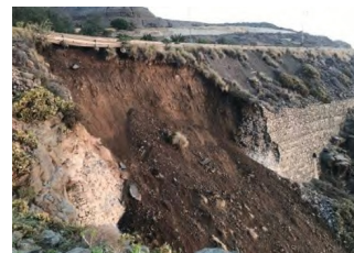
Ilustración 9. Derrumbe carretera GC-1. Isla de Gran Canaria Fuente: Tiempo de Canarias
